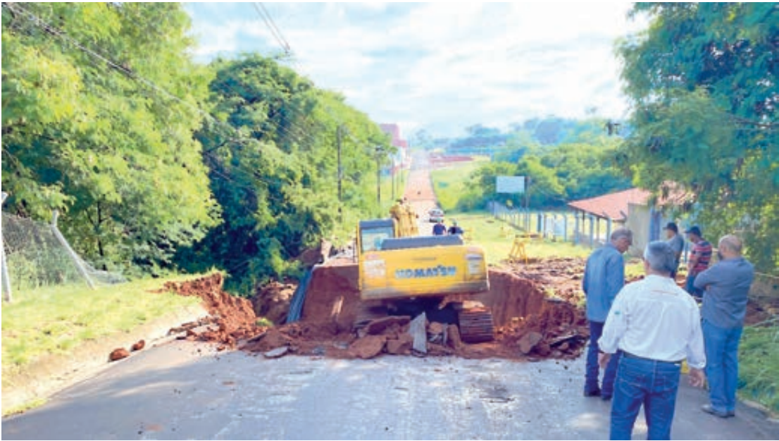
Nesta avenida, chuva forte abriu uma cratera na pista
