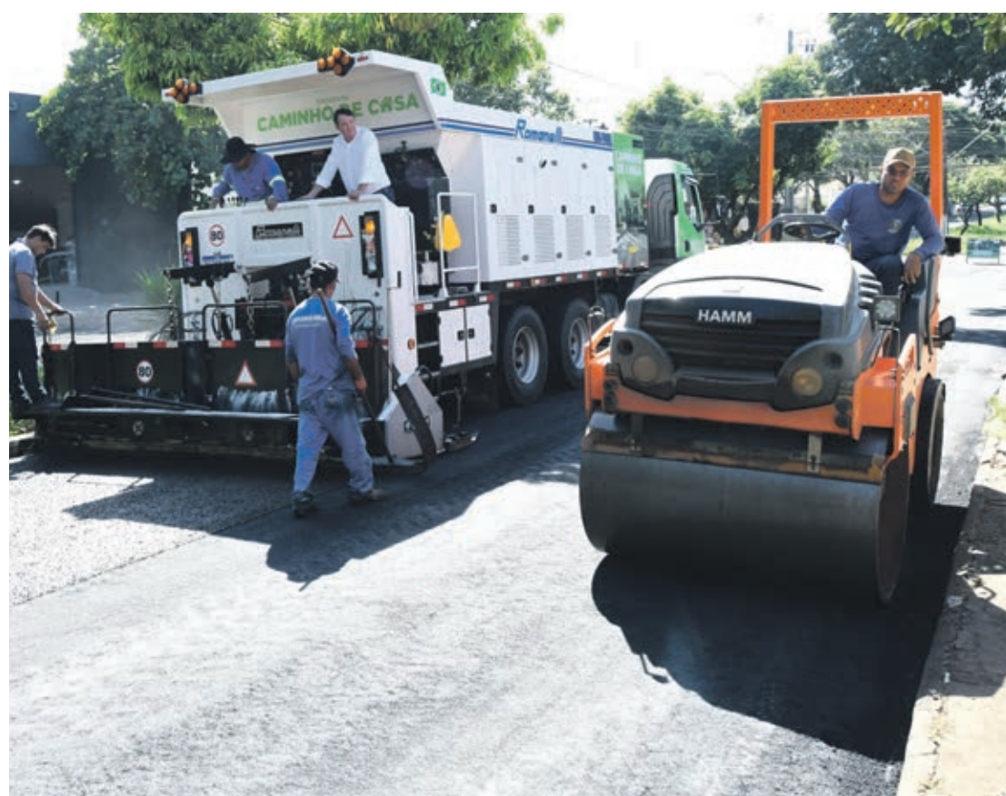
A intenção do prefeito Pimentel é manter o ritmo de trabalho e atender todas as regiões da cidade com a micropavimentação
