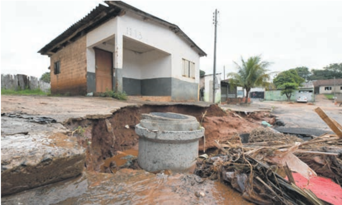
Várias casas ficaram alagadas, fossas transbordaram, calçadas quebraram e o asfalto ficou destruído em vários pontos do bairro
