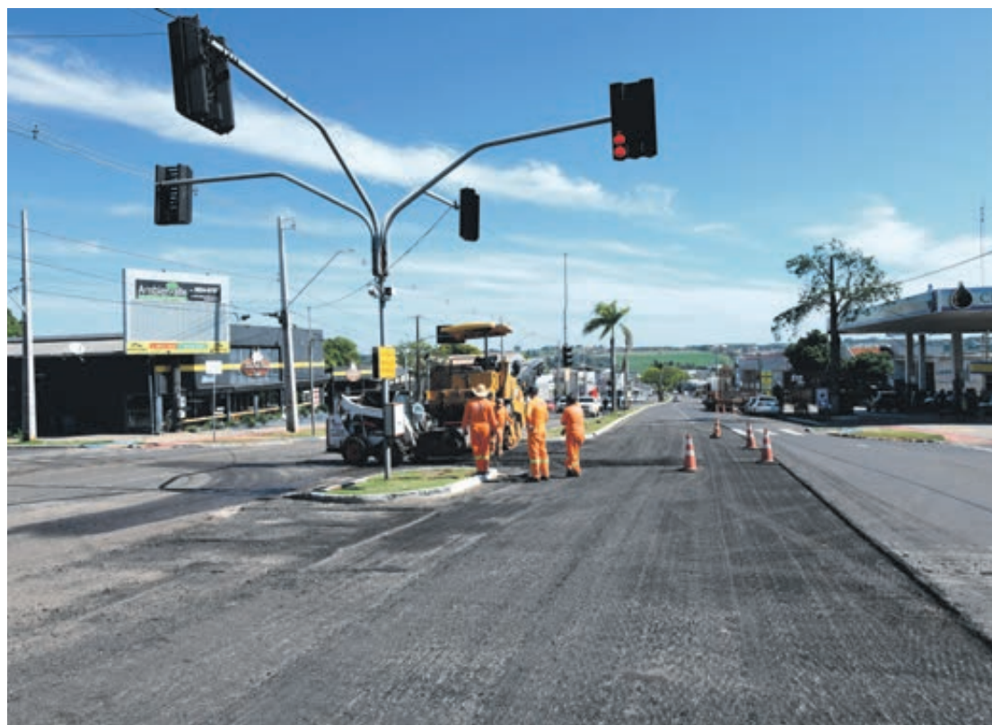
Vários trechos do pavimento asfáltico da Tiradentes, uma das principais vias de acesso a Umuarama, receberão reparos
