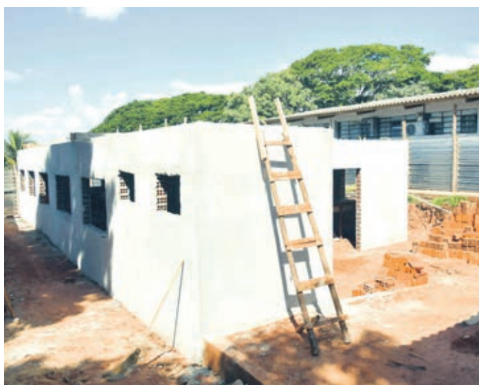
UMUARAMA MULTA EMPRESAS - A Prefeitura de Umuarama instaurou diversos processos administrativos para apurar supostas irregularidades na execução dos contratos de obras no município. Pelo menos três processos já foram finalizados e os demais continuam próximos da finalização. Página A3
