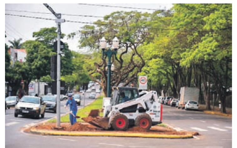
A Prefeitura inicia nos próximos dias mais uma obra de recapeamento asfáltico e galerias pluviais
