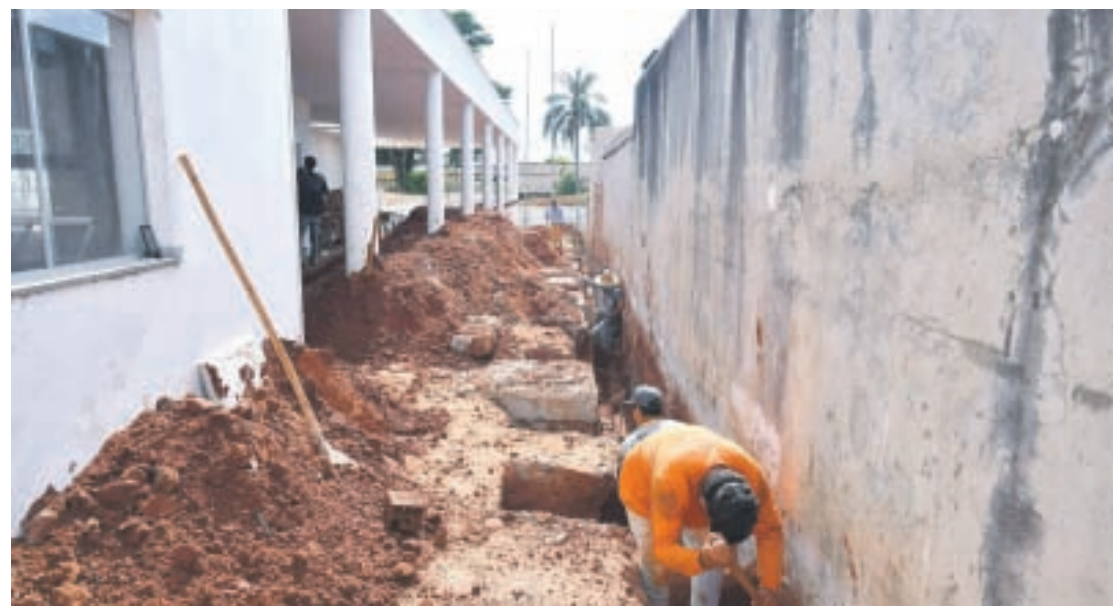
A estrutura terá quase 1,5 mil m² com uma ampla cozinha, refeitório, setor de administração e demais instalações
