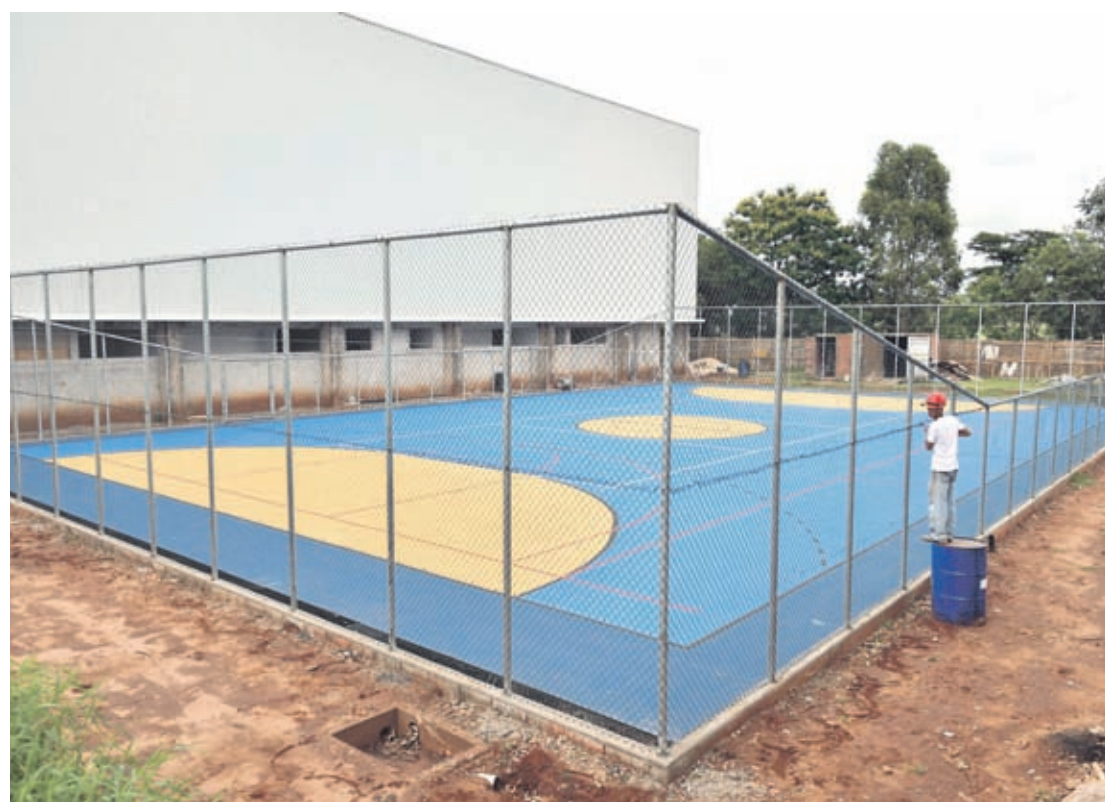
Construção do Centro de Iniciação Esportiva do Sonho Meu já tem quadra externa
